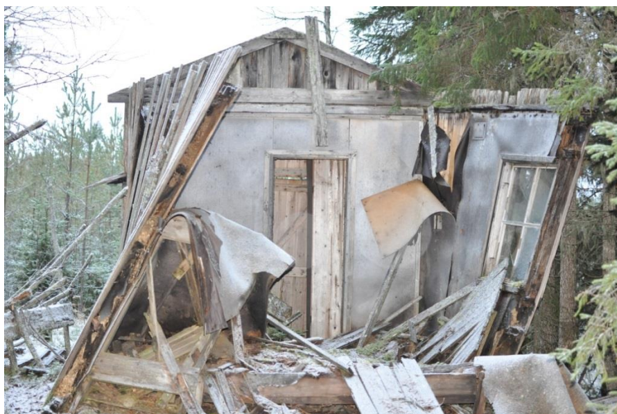
Figur 18. Mauritzkojan som ligger 750 meter från närmsta vindkraftverk är i bedrävligt skick.
